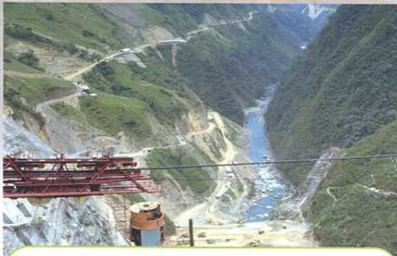
Sitio en el que se levantó la presa después de secar el lecho del río, desviado por un túnel.
