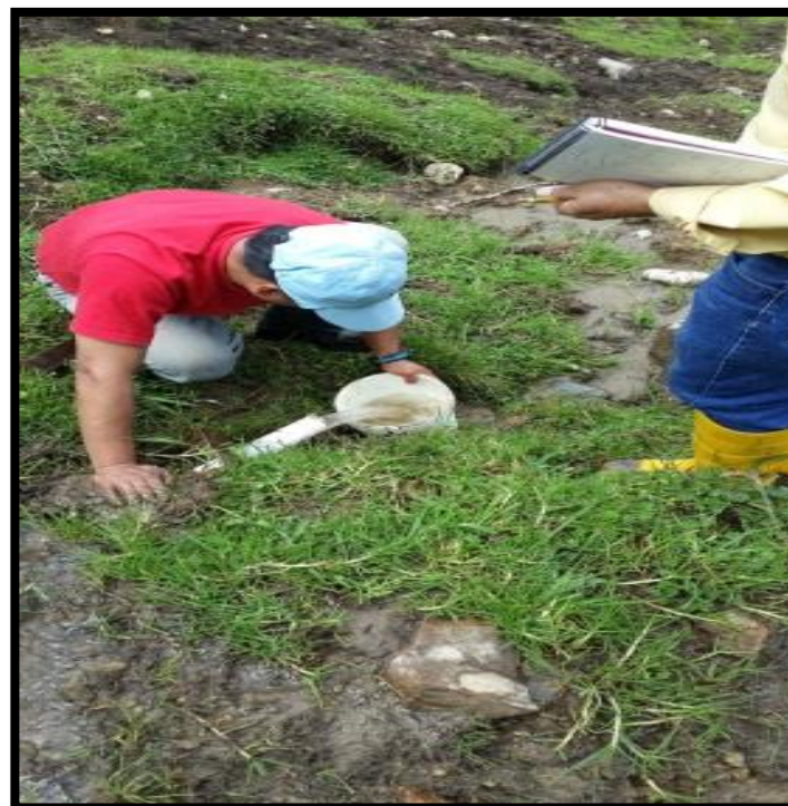
DETALLE DE OBRA: Aforo para la construcción de los sistemas de agua potable del barrio Rumicorral.
