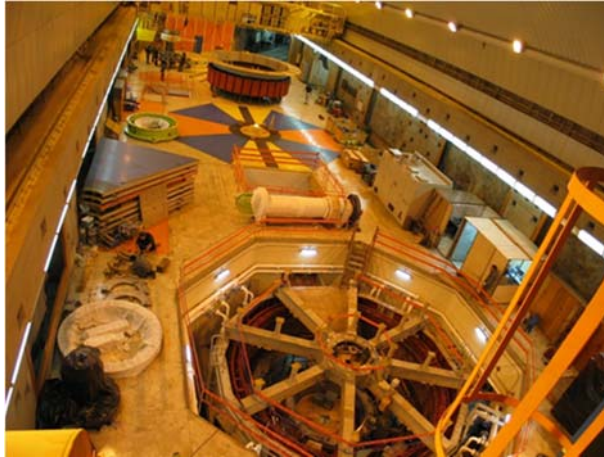
Ilustración 2 VISTA CASA DE MAQUINAS DURANTE EL MANTENIMIENTO
