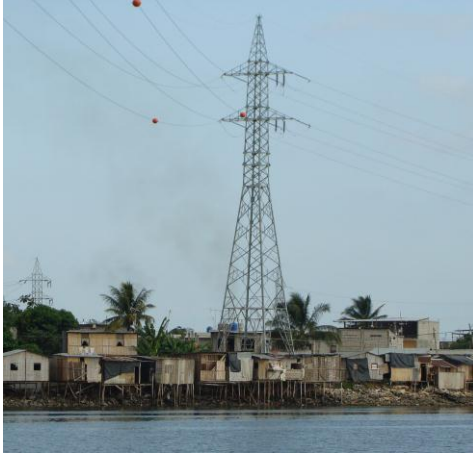
Foto 3: Estructura tipo (Acero Galvanizado) suspensión y retención
