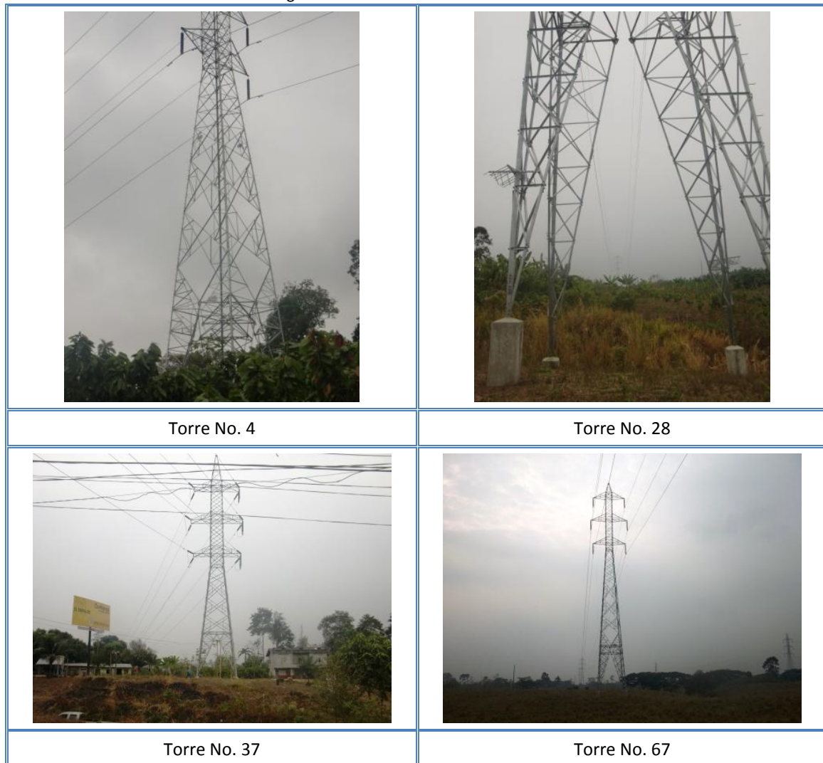
Figura 8-1. Línea de transmisión eléctrica
