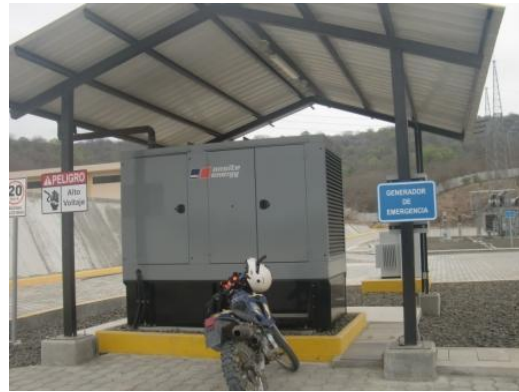
Generador de Emergencia
