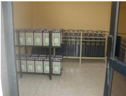
Cuarto de Baterías
