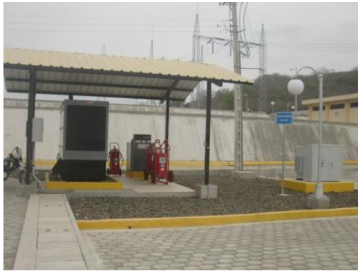
Transformador de Emergencia
