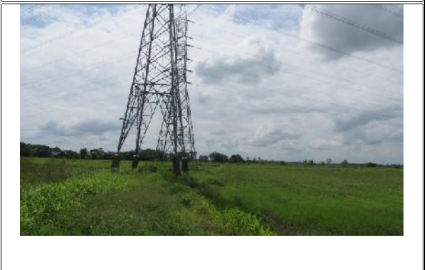
FOTO No. 191. L/T LAS JUNTAS-POSORJA-SANTA ELENA
