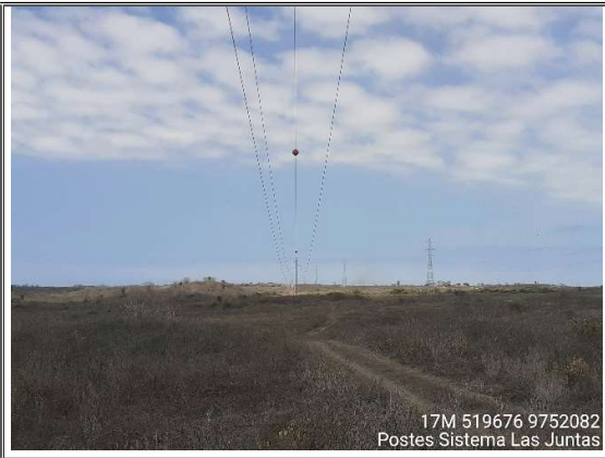
FOTO No. 35. POSTES DEL SISTEMA LAS JUNTAS
