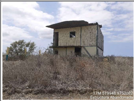
FOTO No. 37. ESTRUCTURA ABANDONADA
