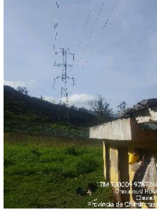
FOTO No. 14. PANORÁMICA, SECTOR ALAUSI, TORRE E135-134
