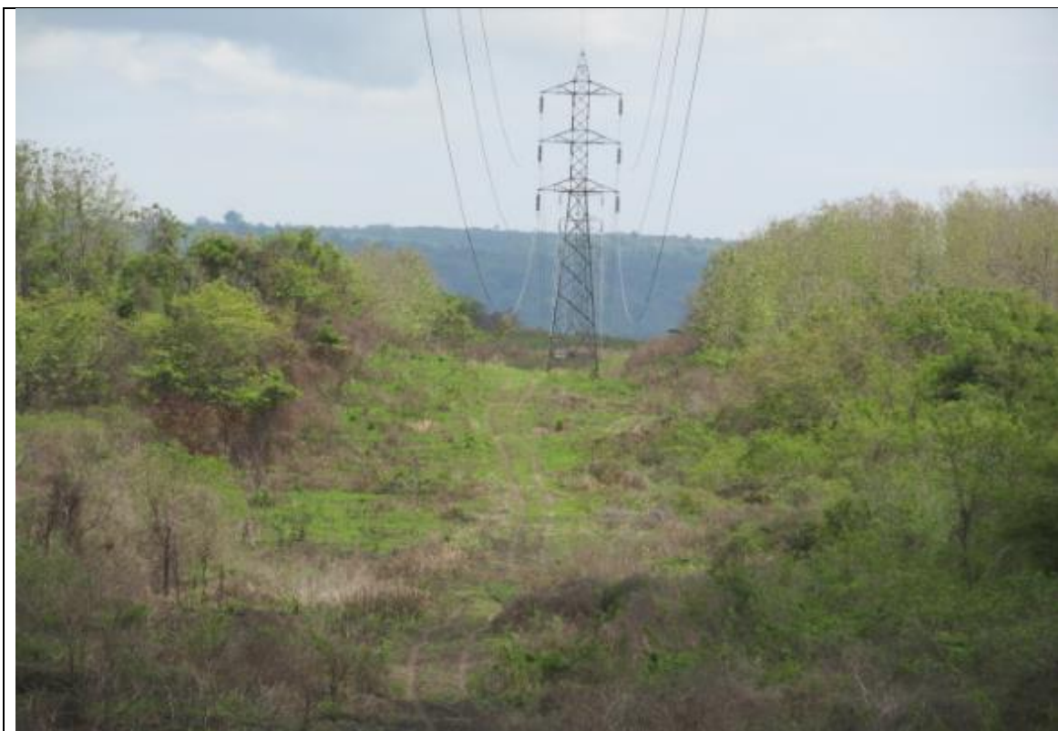
FOTO No. 5.56. LÍNEA DE TRANSMISIÓN, PASCUALES-CHONGÓN-POSORJA, COORDENADA DE REFERENCIA 590434 E 9758672 N (WGS84).
