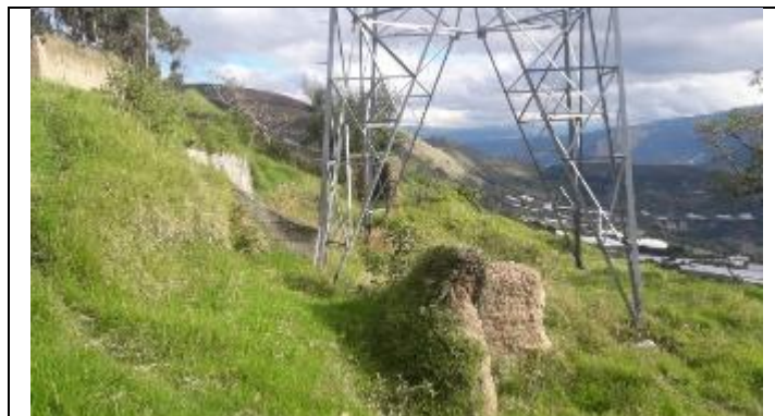
FOTO No. 5.184. E127 SE OBSERVA EROSIÓN. COORDENADAS E 837346 - N 10036507
