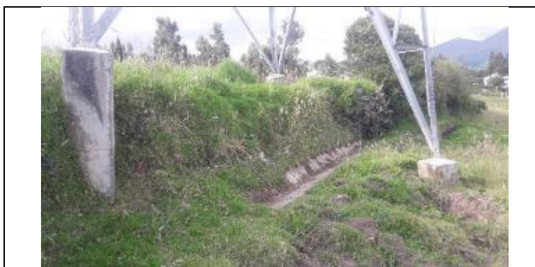
FOTO No. 5.169. E053 CUNETA tapada. coordenadas: E 812398 - N 10009445
