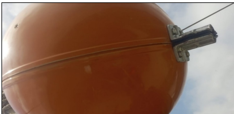
Fotografía informativa 1: Protección de caucho o neopreno:
