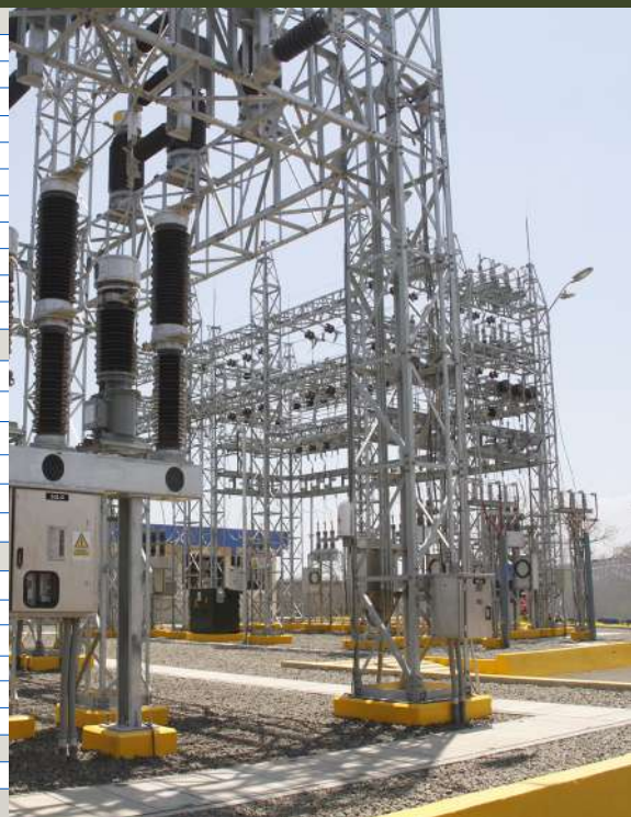
Subestación Eléctrica Jaramijó Manabí - Ecuador
